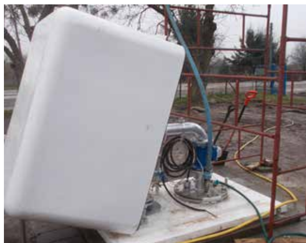
Nowa studnia głębinowa – fot. B. Belter
